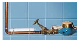
Installation idéale de l'activateur mobile Weber Isis sur la conduite d'eau
